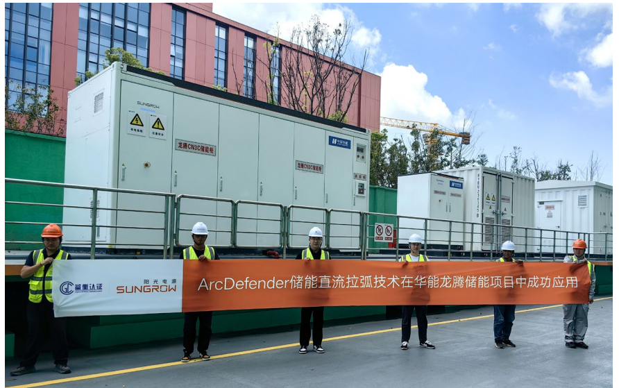
图25 ArcDefender™储能直流拉弧技术在实际储能项目应用成功
